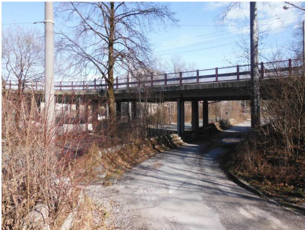
Foto 2 Unterführung beim P&R-Platz Salzburg Süd: Adaptierungen für Durchfahrtsbreite und Durchfahrtshöhe sind zu erwarten (z.B. Absenkung des Fahrbahnniveaus)
